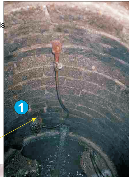
1. Das Problem: Wandschalen werden in der Folge von chemischen Prozessen undicht.
